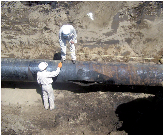
Ducto dañado por explosión.
