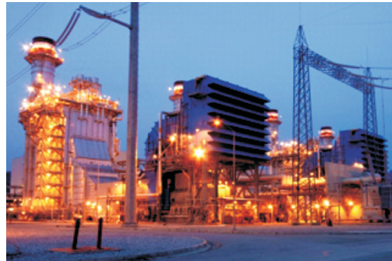
Instalación para la generación de energía eléctrica (CFE).
